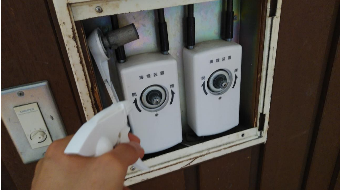
剣道場内の排煙装置のハンドルの消毒
