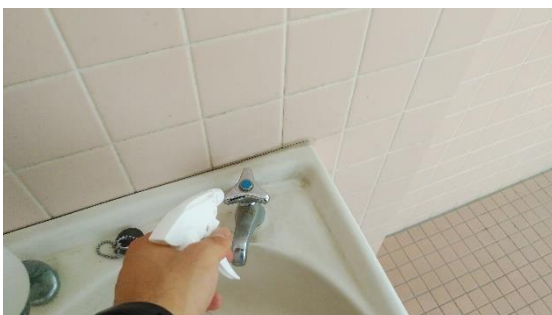
武道館 1 F のトイレの蛇口
